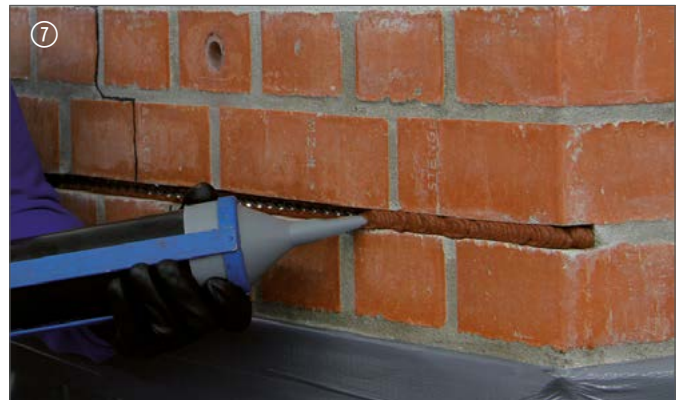
7 Zweite Lage DESOI Spiralanker einbringen | Insert second layer of DESOI spiral anchor
