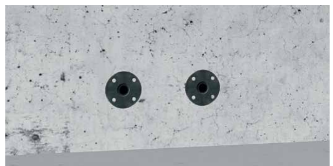
② Nagelpacker nach Entfernen der Schalung ② Nail packers after removal of framework
